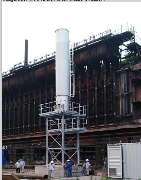
Abb. 3: Gasfackel ( Q_L = 1.000 \text{ m}^3/\text{h} ) zur Bodenluftreinigung
