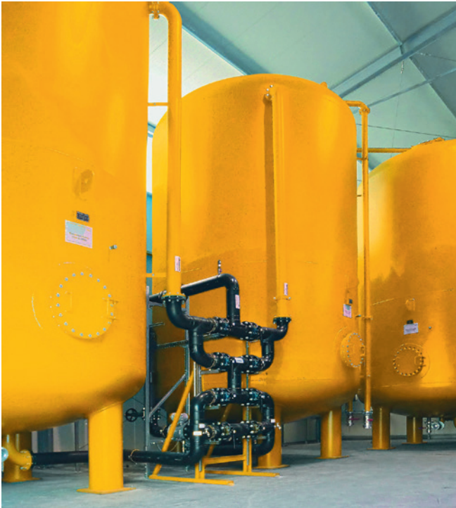
Abb. 1: Stationäre Reinigungsanlage für PFC-haltiges Grundwasser, Durchsatz max. 360 m 3 /h
