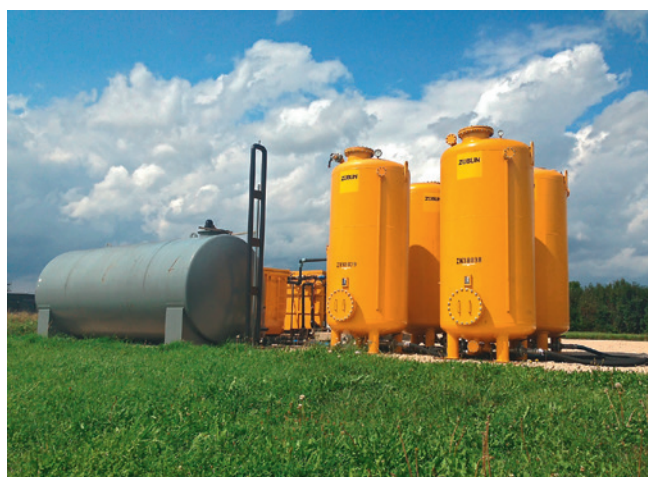
Abb. 6: Mobile Reinigungsanlage für PFC-haltiges Grundwasser, Durchsatz 10-30 m 3 /h
