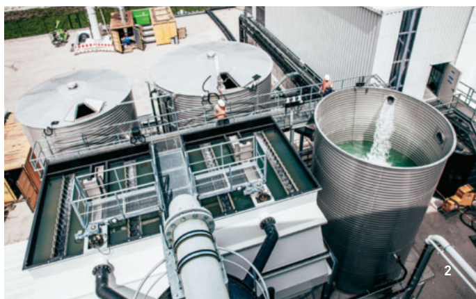
1 Bassin de sédimentation, filtres à sable et à charbon actif, IN-Campus Ingolstadt / 2 Installation de traitement des eaux, épuration du sol, IN-Campus Ingolstadt / 3 Bassin de sédimentation, centrale thermique Mühlhausen
