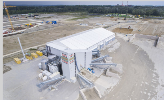
Abb. 2: Nassklassieranlage für PFAS-haltige Böden, ehem. Raffinerie in Ingolstadt, Durchsatz bis 1.200 t Boden/d, integrierte Prozess-/ Schlammwasserbehandlung
