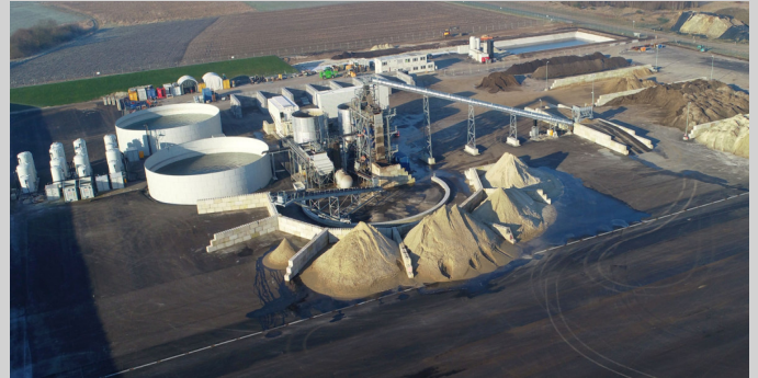
Abb. 1: Bodenwaschanlage PFAS TerraPure®, Militärflughafen in Norddeutschland, Durchsatz ca. 2.000 t Boden/d, integrierte Prozess-/ Schlammwasserbehandlung
