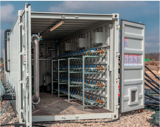
Abbildung 3: Blick in eine Air-Sparging-Anlage mit Injektionseinheiten
