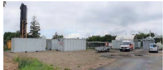
Abb. 11: Sanierungsanlagen mit Grundwasserreinigungsanlage (links)
